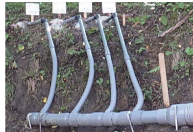
法面に沿わせた配管
