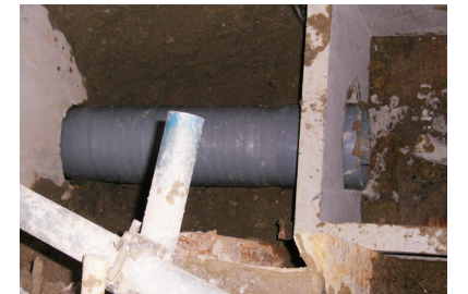
住宅地下排水配管
