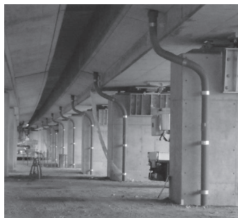
橋梁・高架排水配管
